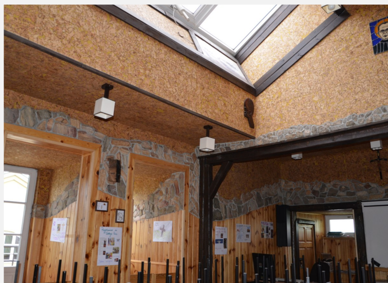
▲ Nad salą do nauki religii znajduje się przeszkolony dach.
